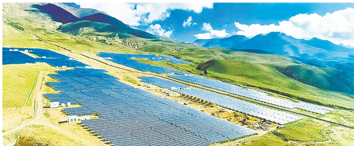
图为措美县城附近山坡上的一排排光伏发电板。
