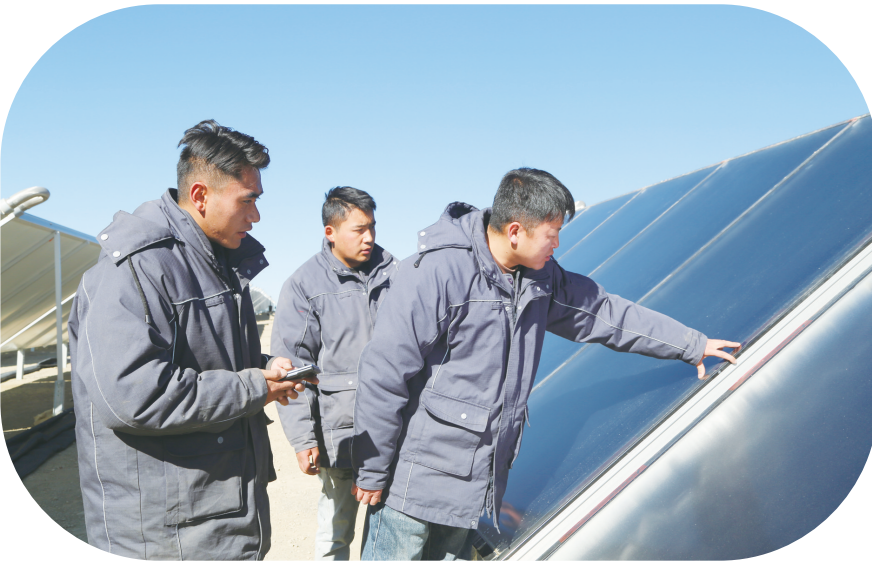
图为隆子县太阳能集中供暖运维站站长梅泽带领工作人员进行集热场日常巡查。
